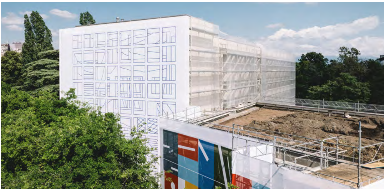
Bâche monumentale réalisée par l'artiste Nigel Peake lors des travaux de rénovation.
